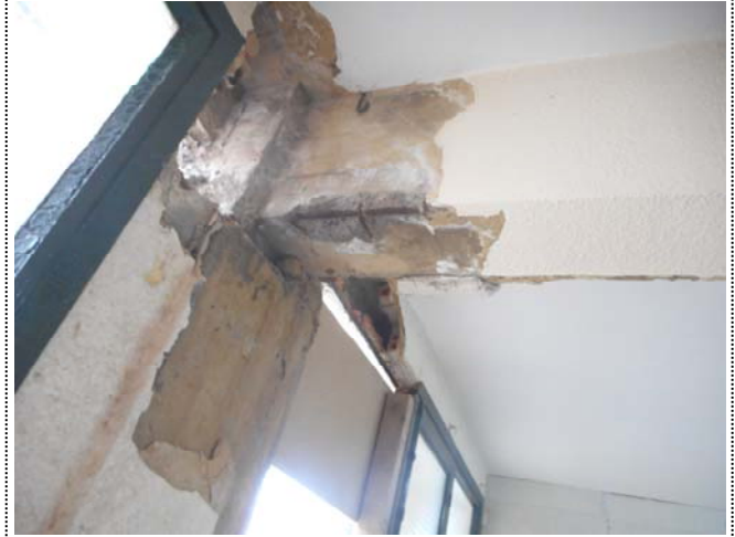
Foto 1403. 07/11/2014. El apoyo de la viga sobre el pilar de la fachada está ligeramente dañado; será necesario repararlo. En su entorno se ha descubierto una junta estructural por la que se filtra la lluvia (ver foto 1411).
