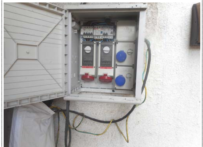
Foto 1408. 07/11/2014. Se comprueba la instalación del cuadro eléctrico de obra . El Constructor presentará al D.O. el certificado de la instalación suscrito por el instalador. Se ha comprobado la puesta a tierra.
