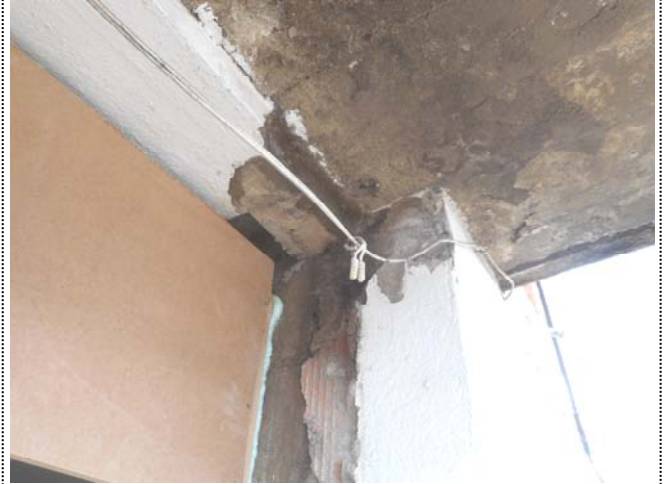
Foto 1411. 07/11/2014. El Constructor muestra la junta estructural por la que escurre el agua.
