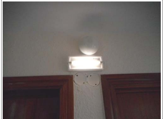
Foto 8198. 02/06/2015. Se comprueba instalación y funcionamiento de alumbrado de emergencia en rellanos de escaleras. Es correcto.
