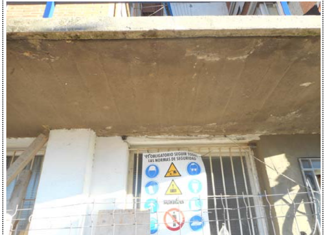
Foto 1773. 22/12/2014. Se muestra a la Comisión el daño que provoca en el sofito de la placa de desembarco de la escalera la filtración de agua que se produce a través de la junta estructural. La Comisión solicita el saneado y pintado del sofito .
