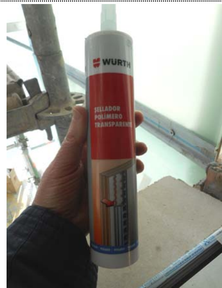
Foto 2329. 10/03/2015. Se comprueba material de sellado del acristalamiento. No corresponde con la referencia comercial especificada en proyecto. Preséntese ficha técnica del producto. Revisense advertencias expuestas (véase Memoria 18/febrero; foto 2191).
