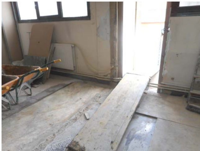
Foto 1402. 07/11/2014. Es necesario modificar parcialmente el trazado de los tubos de calefacción situados sobre la fachada . Convóquese al calefactor que realiza el mantenimiento de la instalación para concretar las actuaciones necesarias.
