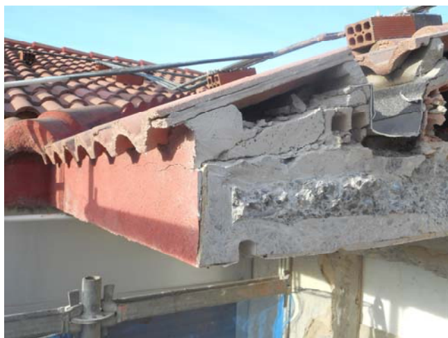
Foto 1879. 14/01/2015. Se observa que el mortero de apoyo de las tejas que cubren el borde del alero está fisurado. Con el tiempo, podrían producirse desprendimientos. Es conveniente rehacer la primera hilada de tejas, mejorando su asiento.
