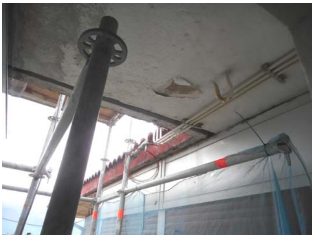
Foto 2957. 29/04/2015. Se aprecia que el sofito del alero está muy envejecido; necesita ser saneado y repintado. Esta actuación no está incluida en el proyecto. Es necesario que la Cdad. exponga sus deseos al respecto. Si desea realizar el saneado debe comunicarlo lo antes posible; antes de desmontar el andamio (plazo disponible: 1 semana).
