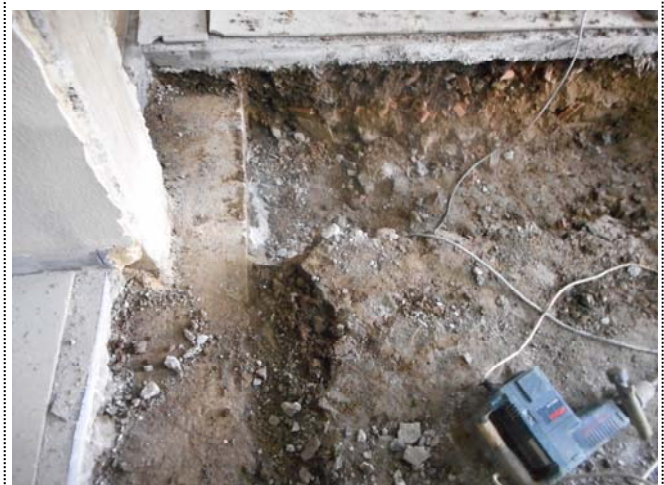
Foto 1401. 07/11/2014. Ha aparecido una zapata corrida, extraordinariamente superficial, apoyada sobre un macizo rocoso. Investíguese si está armada. Prosigase la excavación del resto del foso, según proyecto.
