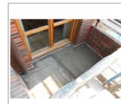
Construcción de nueva capa de formación de pendientes. Incluyendo junta de dilatación perimetral.
