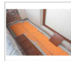
Colocación de baldosas sobre lámina impermeable, con adhesivo y perfiles de remate de bordes perimetrales.
